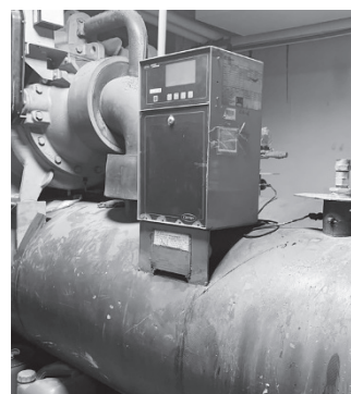
4號冰水主機外觀
