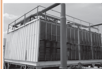
冷卻水塔外觀
